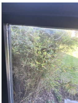
Vinduer og omramming - Sprukket vindu
