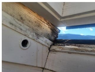
Takvinduer - Fuktskader i takvinduer 1
