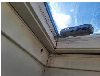
Takvinduer - Fuktskader i takvinduer 2
