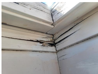
Takvinduer - Fuktskader i takvinduer 3
