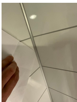
Manglende tettemasse i hjørner
