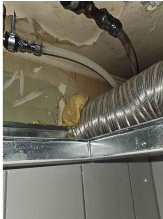
Bildet viser fleksibel kanal over himling.
