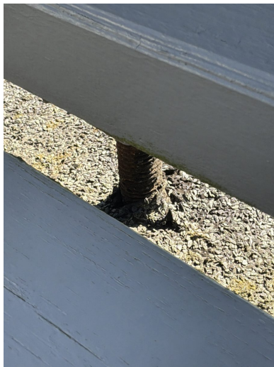
Bilde 10 · Balkonger / terrasser — takbjelke
