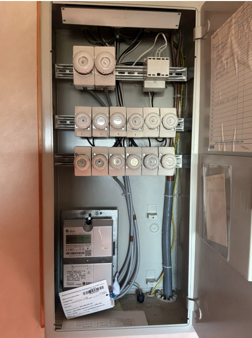
Bilde 24 · Elektrisk anlegg
