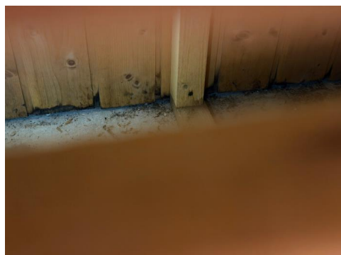
Skader i panel mot yttervegg.
