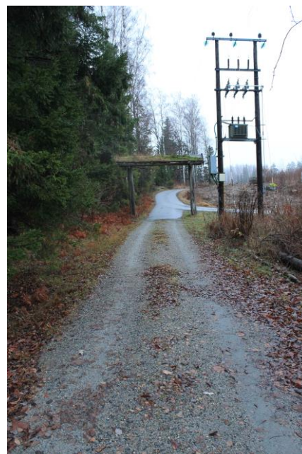
Trafo i mast ved KFUM/KFUK
