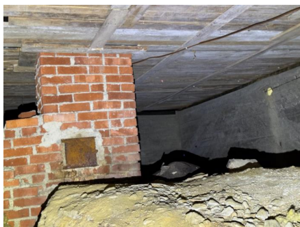
Sotluke i jordkjeller/krypkjeller
