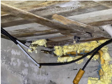
Fuktskader/sopp i overflater av gulvkonstruksjon under bad
