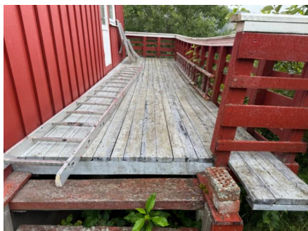
Veranda med skjevheter og slitasje
