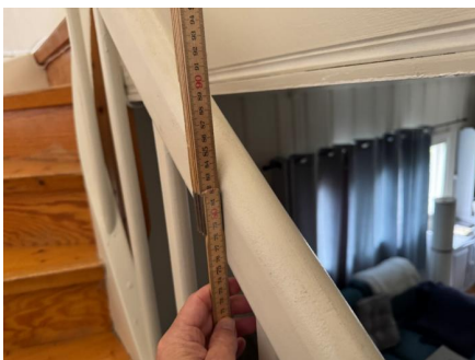
Rekkverk lavere enn 90 cm
