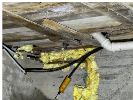
Dårlig innfesting av rør
