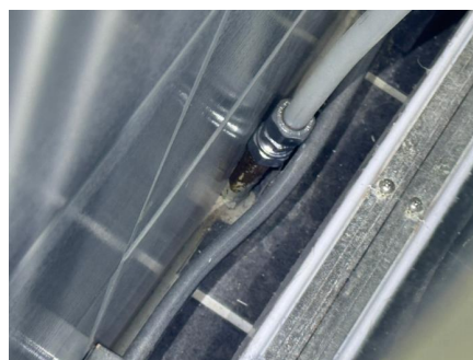
Gjennomføring i gulv bak kabinett med usikker tetting
