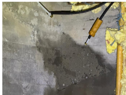
Sprekker i grunnmur
