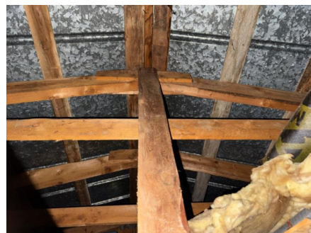
Ikke montert undertak
