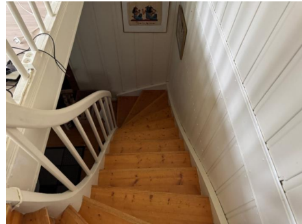
Ikke montert håndlist på vegg
