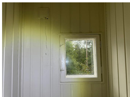
Naturlig ventilering av rommet
