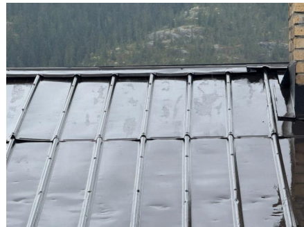
Glippe i skjøter og slitasje i overflater av takteking
