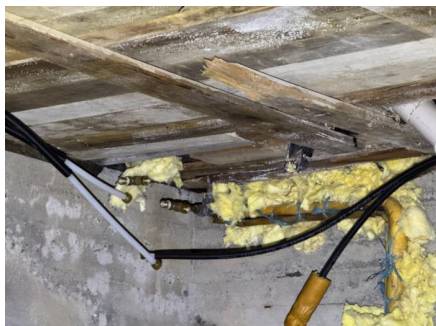
Fuktskader/sopp på overflater av gulv fra krypkjeller/jordkjeller
