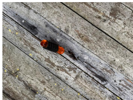
Råte i treverk på veranda
