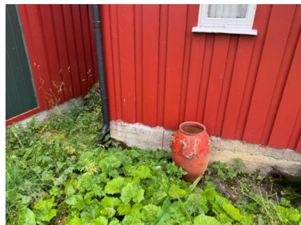
Taknedløp ført ut på grunn utenfor grunnmur
