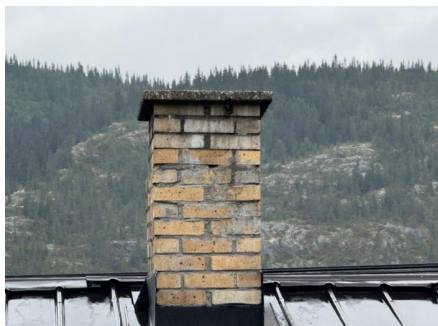
Fotbeslag på pipe over tak
