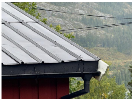
Løse spikre i taktekingen
