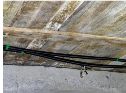
Sopp på overflater i jordkjeller/krypkjeller som indikerer høy fuktighet
