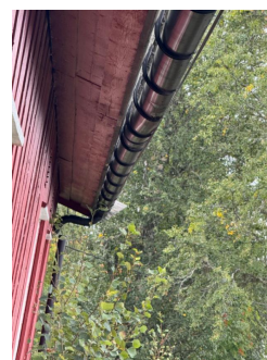
Takrenne og nedløpsrør er ikke sammenkoblet
