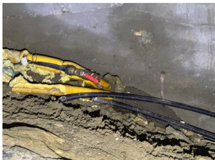
Lekkasje fra vannrør i kjeller der vann renner ned på grunn
