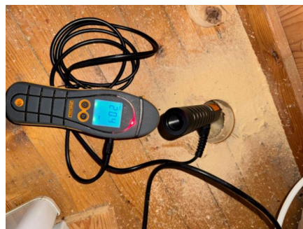
Hulltaking oppforet kjellergulv som viser høy fuktighet
