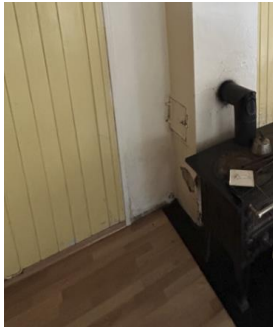
Mangler ubrennbar plate på gulv under feieluke.
