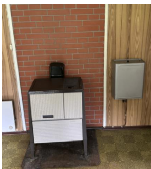
Parafinovn med liten vegghegt tank. Denne er ikke lengre lov å benytte.
