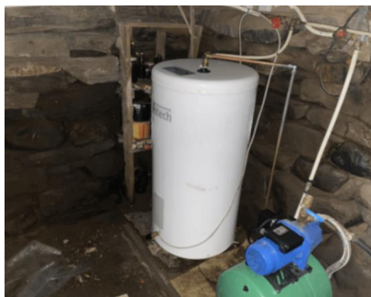
VVB plassert i krypkjelleren med tilkomst fra kjøkkenet.
