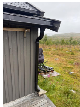
Bulker på nedløp og manglede bort ledning av vann mot sør øst
