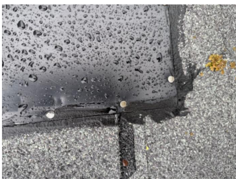
Papp spiker rundt pipebeslag må utbedres.
