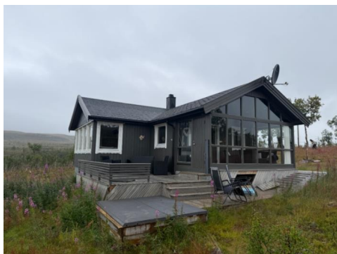
Fukt optrekk, vedlikehold og utskifting må påregnes.
