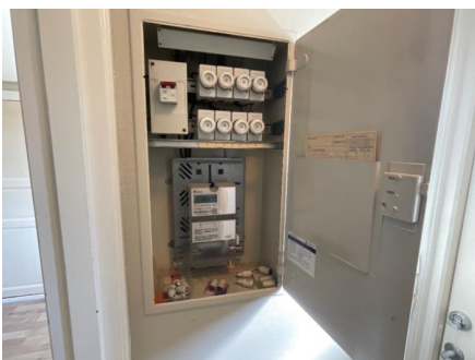
Sikringsskap er plassert i entré.
