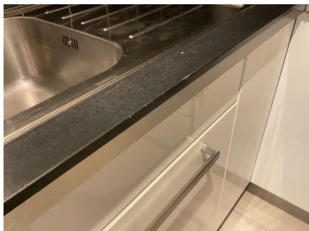
Noe slitasjer/skader er registrert.
