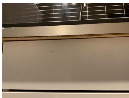
Fuktsvelling på underside av benkeplate.
