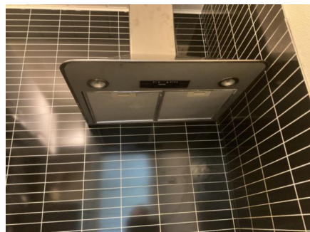
Begrenset funksjon/ sugeevne fra kjøkkenventilator. Lys under virker ikke.
