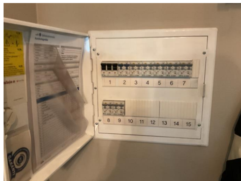
Sikringsskap med automatsikringer.
