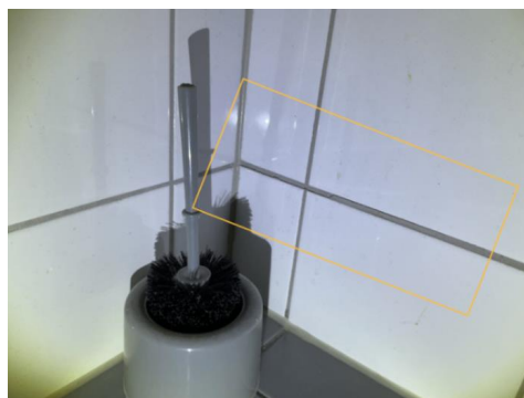
Sprekk i flisfuge.
