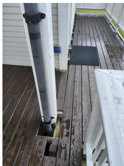
Tilstand på rekkverk og overflatematerialer - Manglende terrassebord
