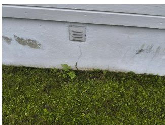
Grunnmur og fundament - Riss i grunnmur
