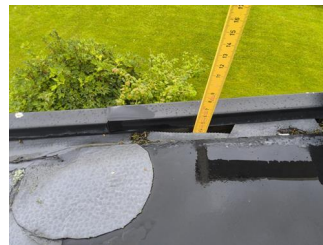
Tekking (med tilhørende beslag) - Skade/utetthet i taktekking
