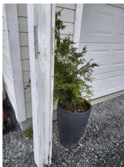
Veggkonstruksjon og fasadematerialer - Slitt overflatebehandling
