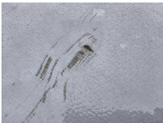
Tekking (med tilhørende beslag) - Skade/utetthet i taktekking
