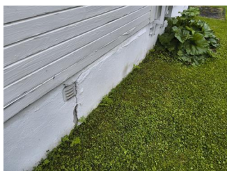
Grunnmur og fundament - Sprekker og symptom på jordtrykkskade
