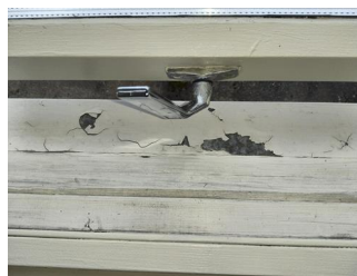
Vinduer og omramming - Slitasje på vannbord
