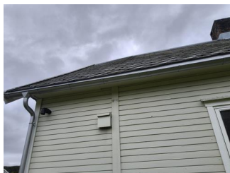
Takkonstruksjon og konstruksjonsoppbygning - Svanke i tak over balkong
