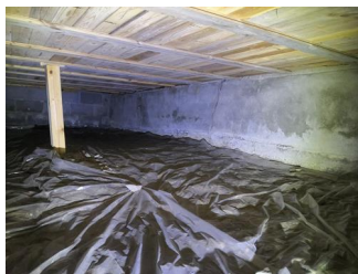
Synlige konstruksjoner - Vegg med symptom på jordtrykkskade
