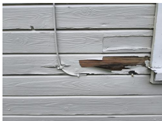
Overflatebehandling - Avflassing i overflatebehandlingen
