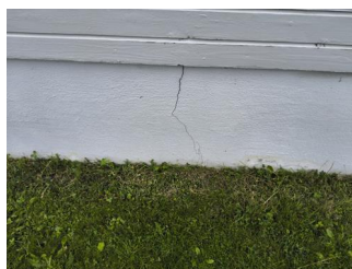
Grunnmur og fundament - Sprekk i grunnmur
