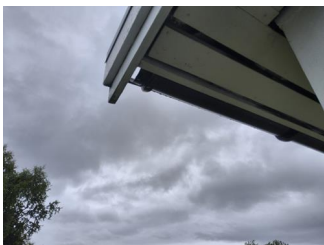
Takrenner og utvendige nedløp - Lekkasje/manglende endeløkk
