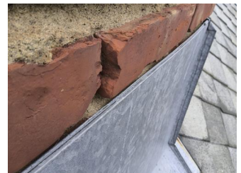
Skorsteiner (over tak) - Utetthet i overgang beslag/skorstein
