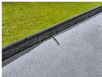
Tekking (med tilhørende beslag) - Skade/utetthet i taktekking
