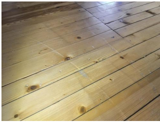
Overflate gulv - Riper, hakk og glipper
