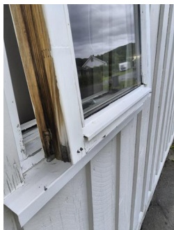
Vinduer og omramming - Skade på soveromsvindu
