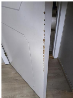
Innerdører - Skade i soveromsdør
