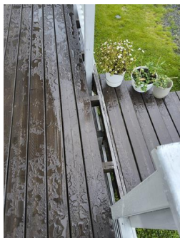
Tilstand på rekkverk og overflatematerialer - Manglende terrassebord
