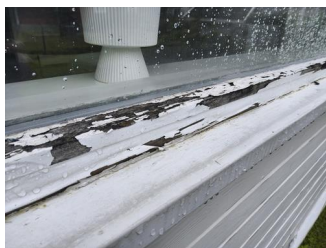
Vinduer og omramming - Stuevindu med råteskader
