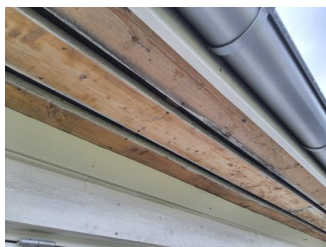
Veggkonstruksjon og fasadematerialer - Manglete overflatebehandling
