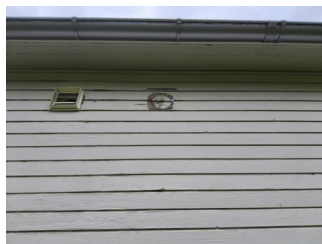
Overflatebehandling - Skade i overflatebehandling etter hull
