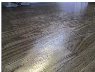
Overflate gulv - Riper og hakk i stuegulv
