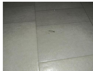
Overflate gulv - Hakk i soveromsgulv
