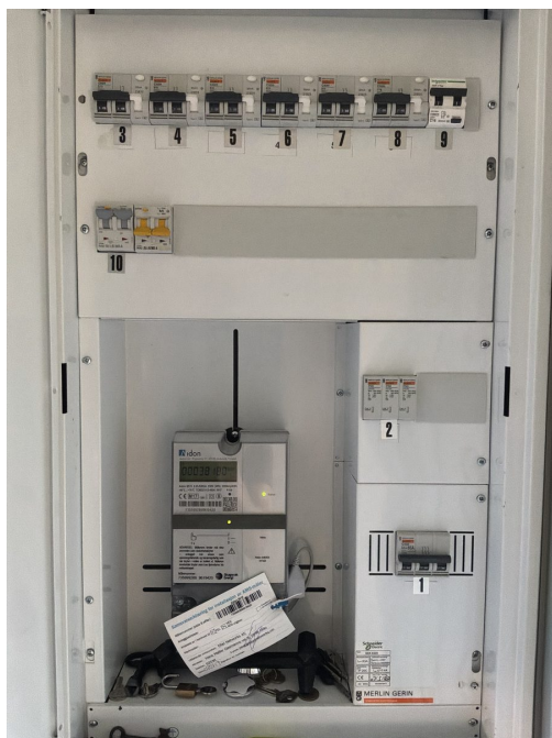
Bilde 16 • Elektrisk anlegg
