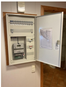
Sikringsskap med automatsikringer.
