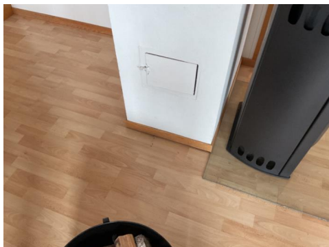
Manglende ubrennbar plate foran sot-/feieluke.
