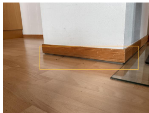
Glippe mellom gulvlist og gulv på ca. 10mm rundt pipe.
