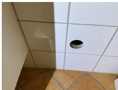
Hull i vegg mellom dusjen og vask uten fuktsikring.
