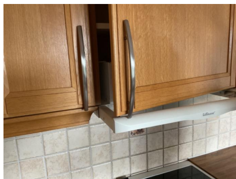
Håndtaket på kjøkkeninnredningen tar i ventilatoren.
