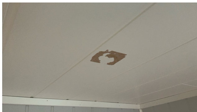
Eksempel slitasje tak.
