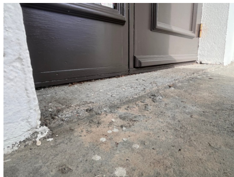
Eksempel manglende beslag.
