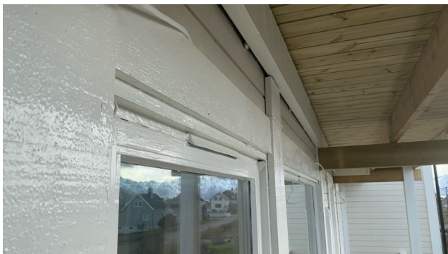
Eksempel manglende beslag.
