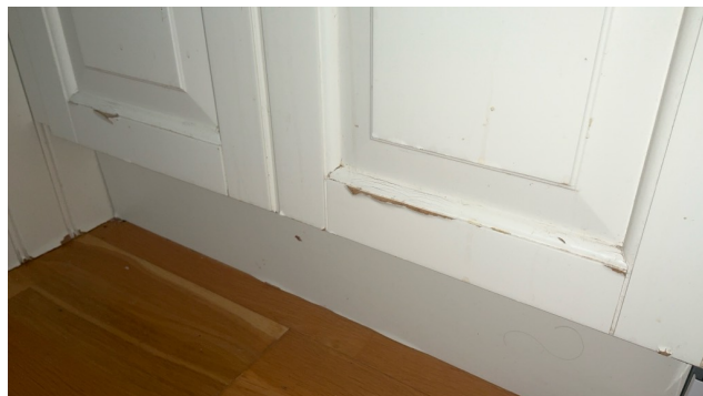
Eksempel skade kjøkkeninnredning.
