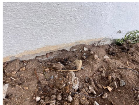
Eksempel på område der fuktsikring ikke kan påvises.
