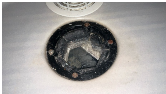
Eksempel plastsluk med korrosjon.
