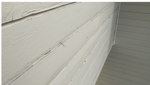
Eksempel værslitt/oppsprukket trekledning.
