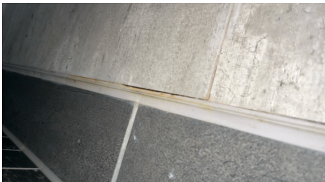
Eksempel manglende fuging av sokkelist.
