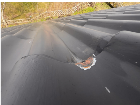
Eksempel korrosjon på takplater.
