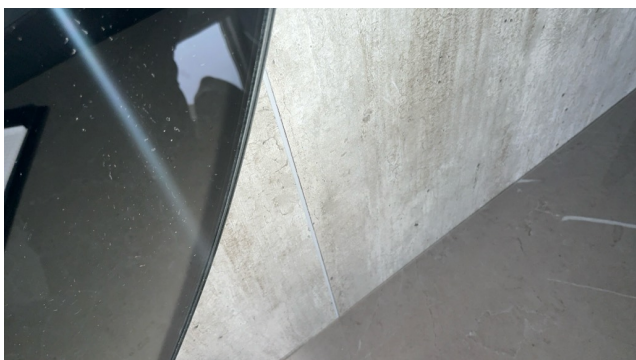
Eksempel manglende fuget plate i våtsone.
