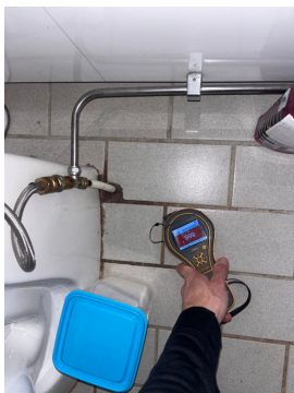
Eksempel overflatemåling med forhøyede verdier.
