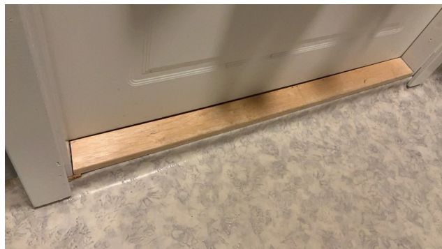
Eksempel manglende tilluft.
