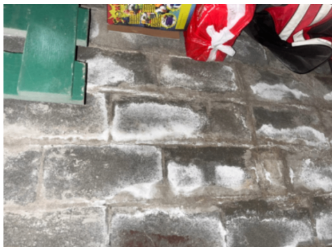
Eksempel grunnmur med saltutslag.
