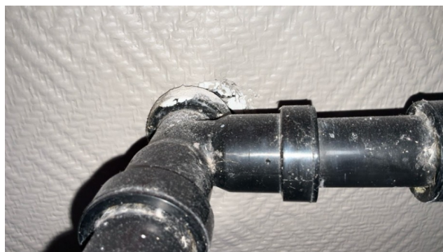
Eksempel utett rørgjennomføring.
