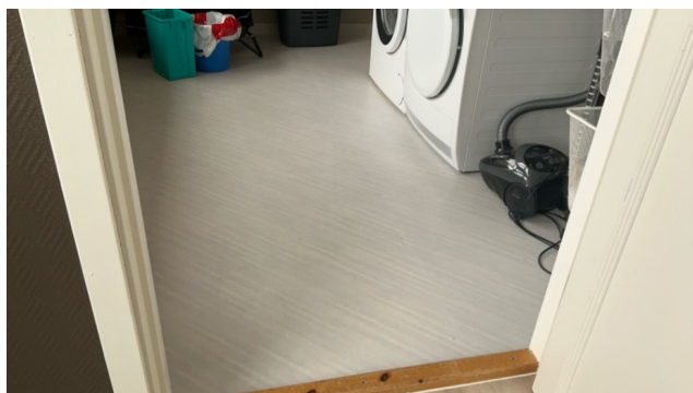
Eksempel overflate med manglende fall (motfall).
