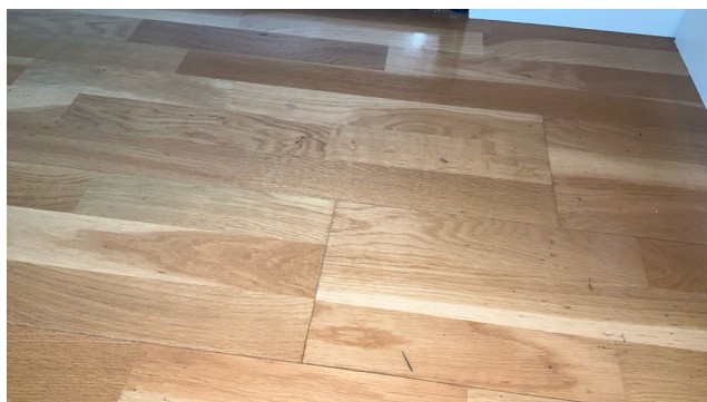
Eksempel slitasje gulv.
