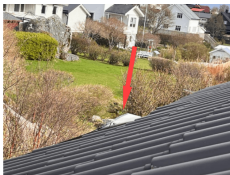
Eksempel på skade/utetthet.
