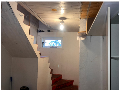
Eksempel på trapp uten rekkverk og håndløper.
