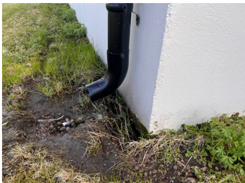
Eksempel manglende bortledning av vann.
