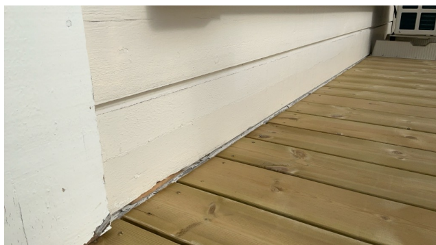
Eksempel værslitt/oppsprukket trekledning.
