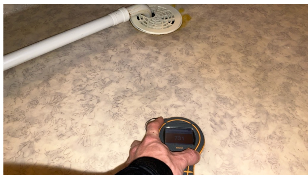
Eksempel overflatemåling med forhøyede verdier.
