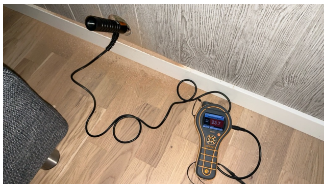
Eksempel fuktmåling med forhøyede verdier.
