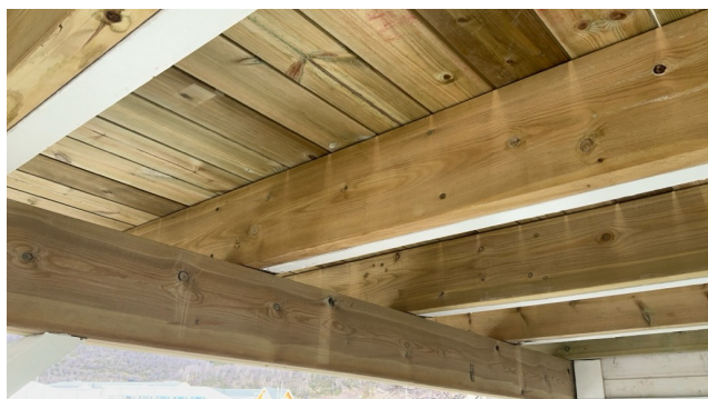
Eksempel manglende vindforankring.
