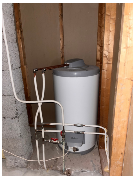
Eksempel kobberør manglende klamret/innfestet.
