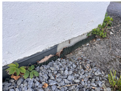
Eksempel på mangelfull fuktsikring av grunnmur.
