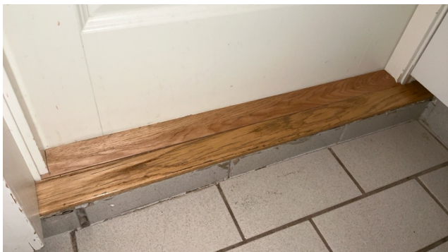
Eksempel manglende tilluft.
