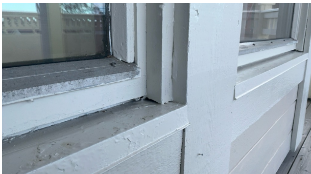
Eksempel manglende luftespalte mellom omramming og beslag.
