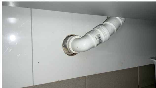
Eksempel utett rørgjennomføring.
