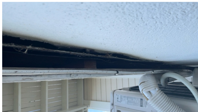
Eksempel manglende musesperre.
