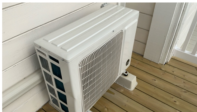
Eksempel nyere varmepumpe.
