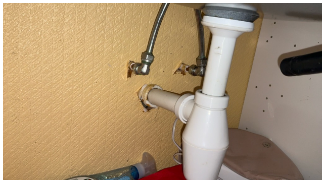
Eksempel utett rørgjennomføring.
