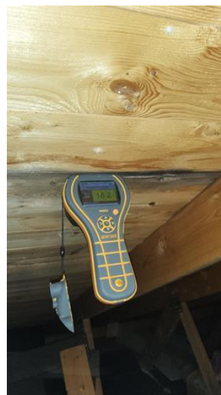
Overflater vegger/undertak - [Misfaring i taktro med fuktmåling]
