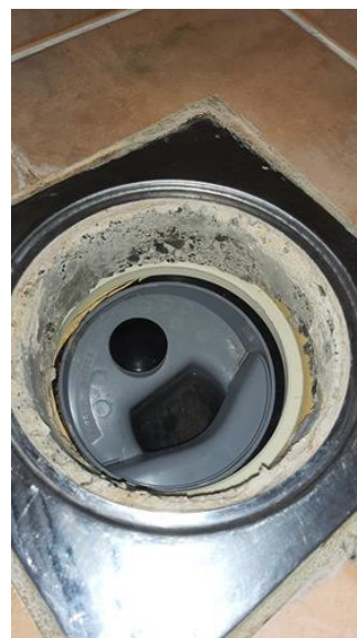
Helhetsvurdering - [Sluk bad 1. etasje]
