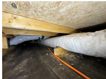
Ventilasjonsrør i kaldloft i oppbygd tak.
