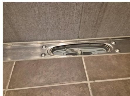
Slukrenne i dusjnisjen.
