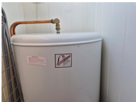
Varmvannsbereder i vaskerom.
