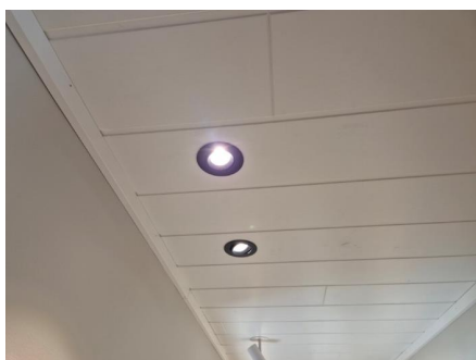
Innfelt spotbelysning i innvendig tak.
