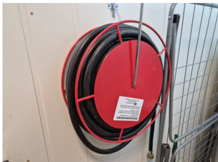
Brannslange i vaskerom.
