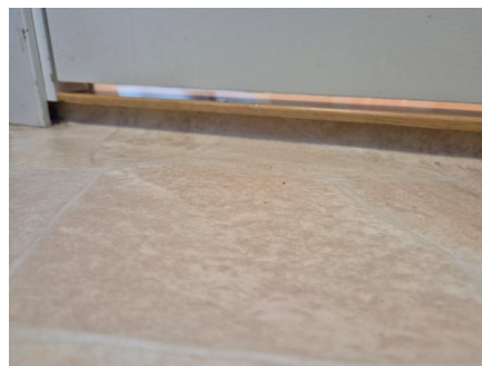
Tilluftspalte under dørblad.
