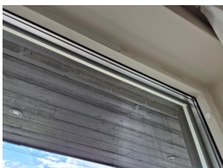
Vinduer med 3 lags energiglass.
