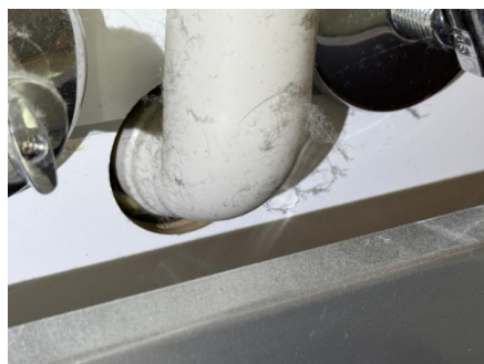
Utett rørgjennomføring i vegg i våtsone
