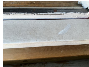
Glippe mellom beslag og dør
