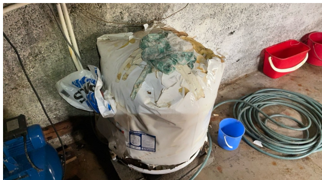
Eksempel eldre varmtvannsbereider med skader.
