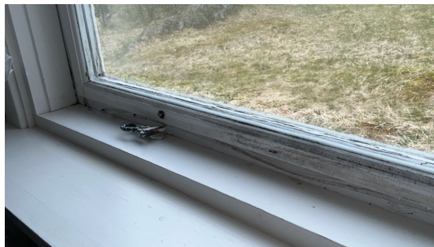
Eksempel eldre vindu med behov for utskiftning.
