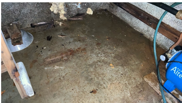
Eksempel synlig fukt/vann på gulv i kjeller.
