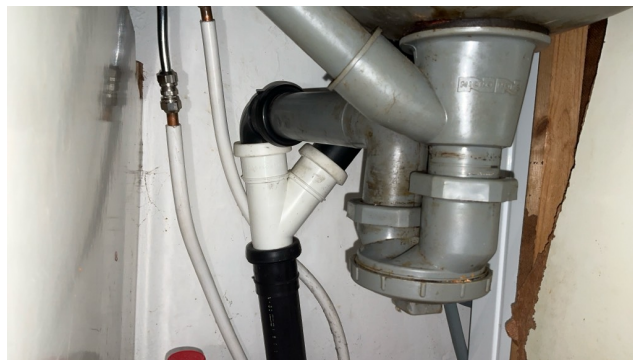
Eksempel eldre avløpsrør.
