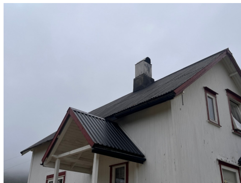
Eksempel takflate med manglende snøfanger.
