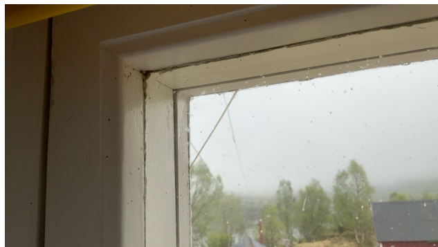
Eksempel sprekk i glassrute.
