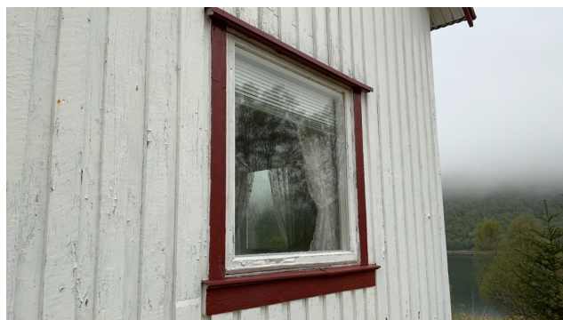
Eksempel vindu med lekkasje.
