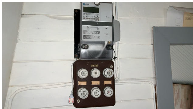
Skrusikringer montert direkte på vegg.
