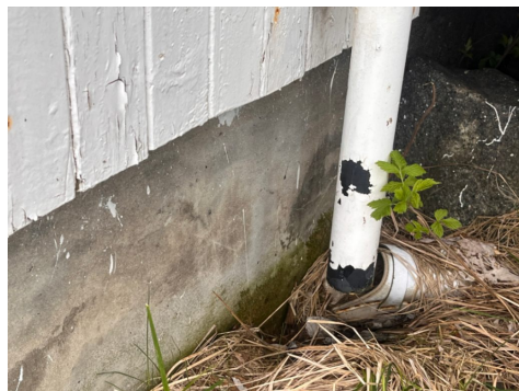
Eksempel mangelfull bortledning av vann ved grunnmur.
