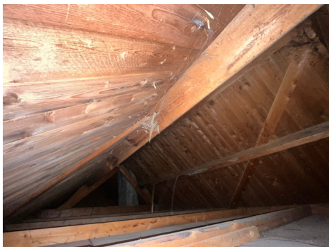
Eksempel uventilert kaldloft med manglende varmeisolasjon og dampsperre.
