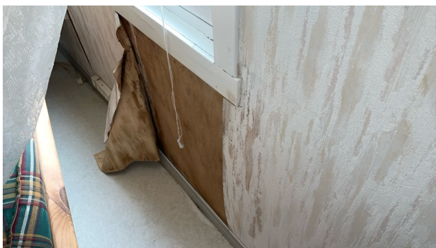
Eksempel innvendig fuktskade ved vindu.
