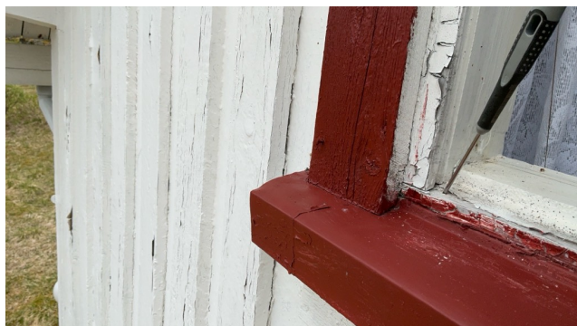
Eksempel manglende luftespalte mellom omramming og beslag.
