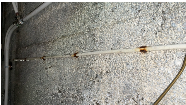
Eksempel synlig fukt/vann på vegger i kjeller.
