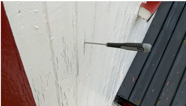
Eksempel råteskadet trekledning.
