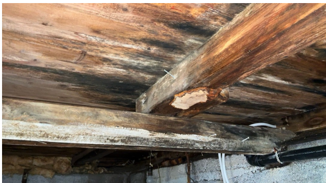
Eksempel fuktskade i etasjeskiller grunnet høy luftfuktighet i kjeller.
