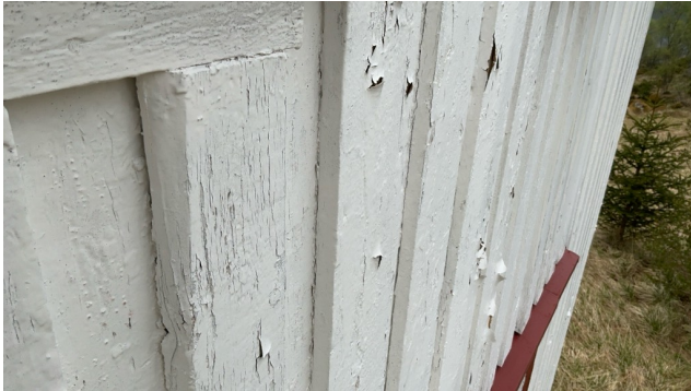
Eksempel trekledning med behov for utskiftning.
