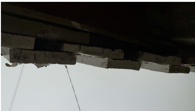
Eksempel trekledning med manglende lufting.
