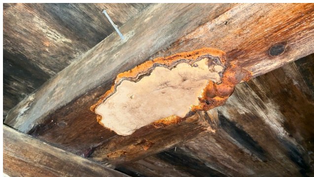
Eksempel sopp på gulvbjelke. Tegn på høy fuktpåvirkning over tid.
