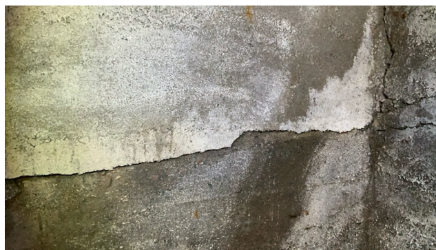
Eksempel horisontal sprekk.
