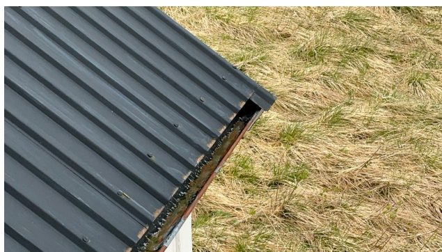
Eksempel korrosjon på takrenner.
