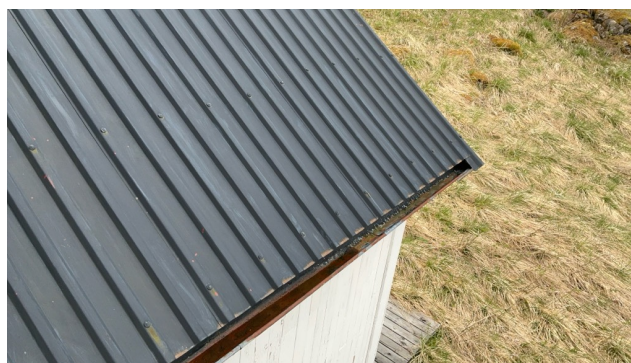
Eksempel korrosjon på takteking.
