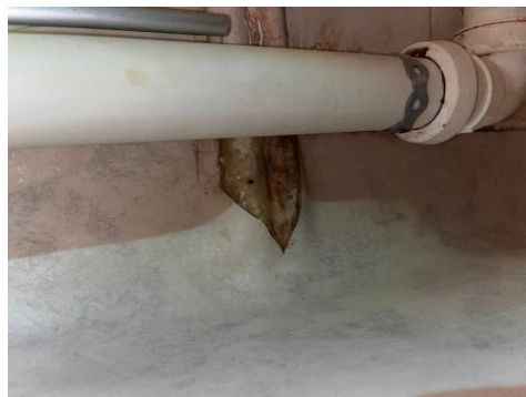
Eksempel utett rørgjennomføring.
