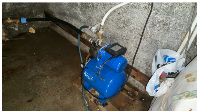
Eksempel delvis defekt vannpumpe.
