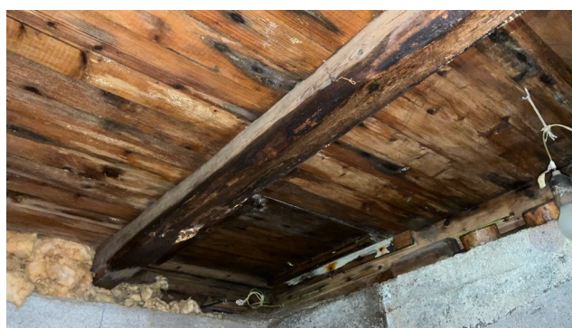
Eksempel fuktskade i etasjeskiller.
