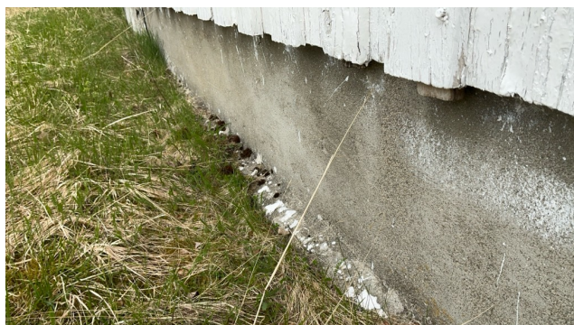
Eksempel manglende fuktsikring.
