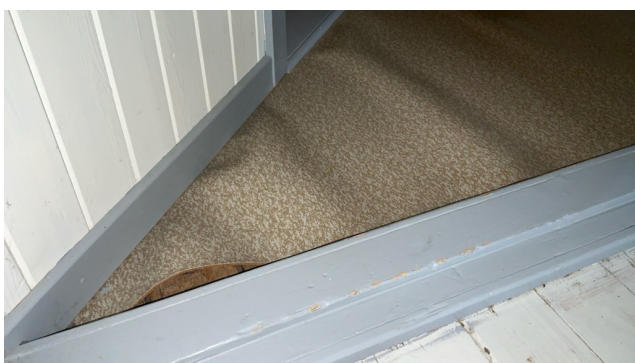
Eksempel skade. Løst gulvbelegg.
