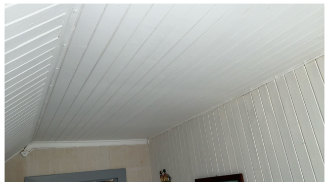
Eksempel innbygd takkonstruksjon uten mulighet for inspeksjon.
