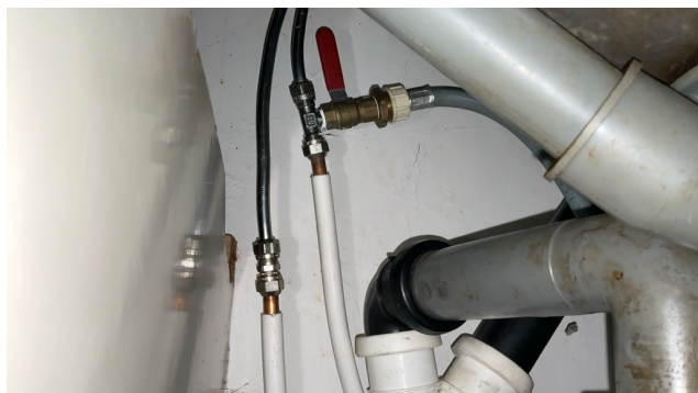
Eksempel eldre vannrør.
