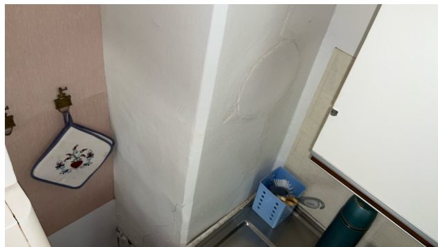
Eksempel sprukket/innbygd pipe.
