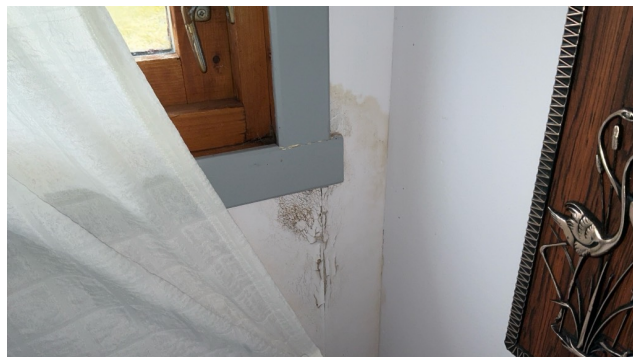
Eksempel innvendig fuktskade ved vindu.
