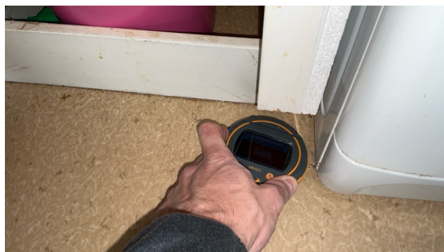
Eksempel fuktmåling på kjøkkengulv med fuktindikator som viser forhøyede verdier.
