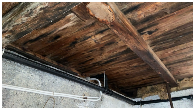
Eksempel fuktskade i etasjeskiller.
