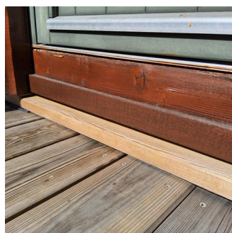
Ytterdører og omramming - Eksempel på glipe og manglende beslag i underkant dør 2.etasje
