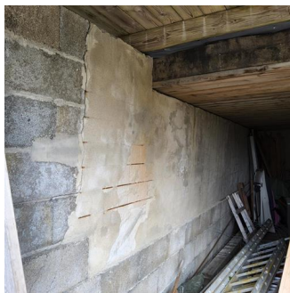
Tilstand - Forstøtningsmur med skader og skjevheter
