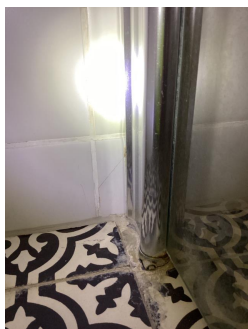
Sprekk i flis ved innfesting av dusjdør.
