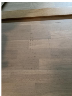
Merker i gulv på gang første etasje.
