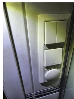
Overflater vegger - Sprukket flis ved lysbryter
