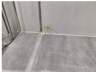
Overflater vegger - Sprukket flis i dusj
