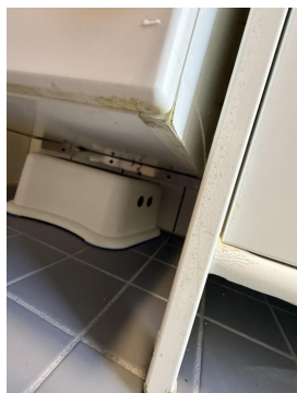
Liten svelleskade i servantskap.
