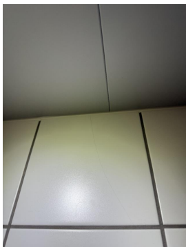
Sprekt flis i øverste rad mot himling utenfor dusjvegger.
