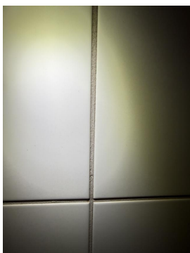
Noe riss i fugemasse mellom fliser i dusjen.
