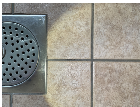
Oppsprekking i flisefuger.
