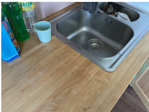
Fuktskader på benkeplaten ved oppvaskkummen.
