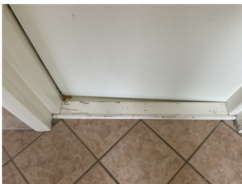
Dørblad tar i terskel.
