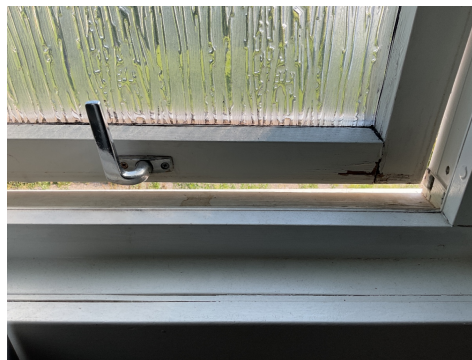
Oppsprukne karmen, trolig som følge av fukt påvirkning fra innvendig kondensering på glass.
