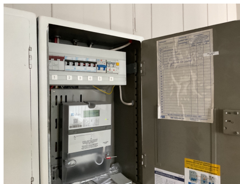
Sikringsskap med automatsikringer.
