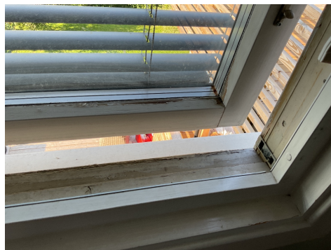
Malingsavflassing og slitasje på vinduene.
