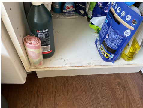
Skader i benkeskap under vask.
