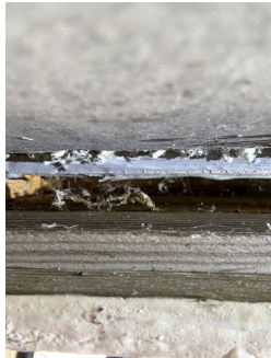
Eksempel på manglende musesperre
