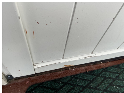
Altandør er noe preget av elde, slitasje
