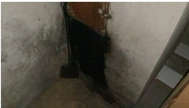
Eldre merker av sotvann på pipe i opprinnelig kjeller.
