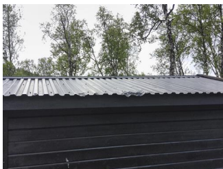
Yttertak og takkonstruksjon - Skader i takplater
