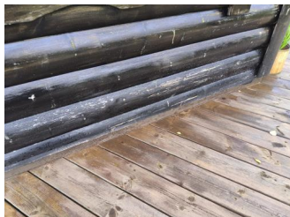
Veggkonstruksjon og fasadematerialer - Slitt overflatebehandling
