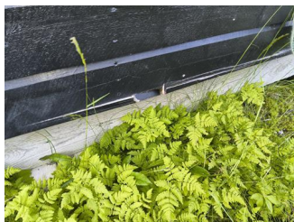
Veggkonstruksjon og fasadematerialer - Skade i panel
