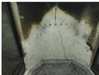
Ildsteder - Sprekk i ildfastplate i peis
