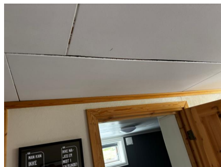
Eksempel på himlingsplater som er løsnet fra lekter.
