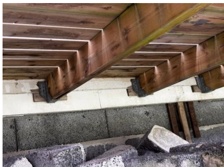
Eksempel på ufagmessig innfesting av bjelkesko.
