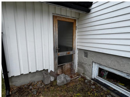
Eksempel på råteskade.
