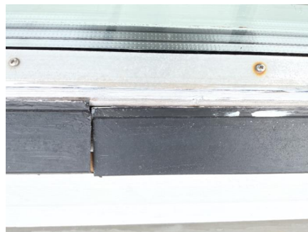
Eksempel på utett beslagsutførelse under vindu.
