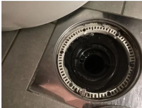
Bilde av sluk utpå gulvet.
