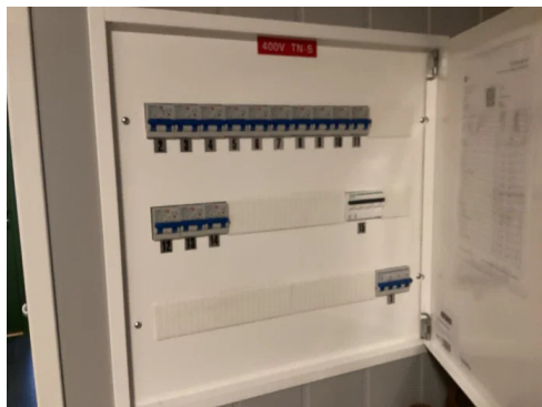
Bilde av sikringskap.
