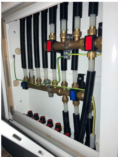
Bilde av rørfordelerskap.
