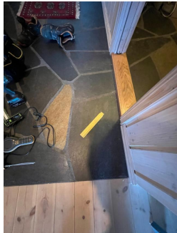
Observert bom/hulrom under en skiferflis i inngangspartiet.
