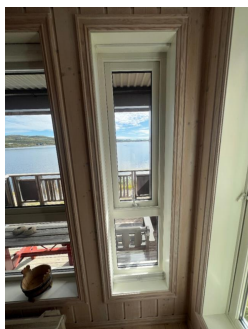
Vinduet i spisestuen tar noe i høyre side av karmen ved åpning og lukking.
