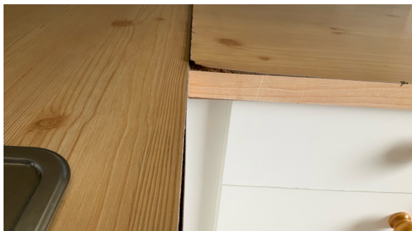
Fuktsvelling i benkeplate.
