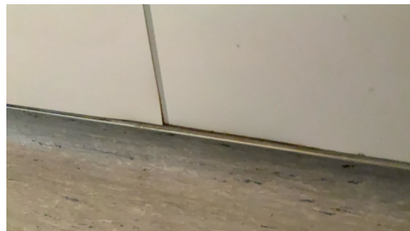
Skader i plateskjøter.
