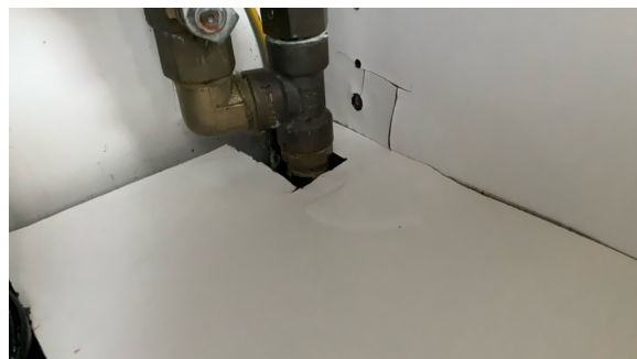
Fuktsvelling i skap.
