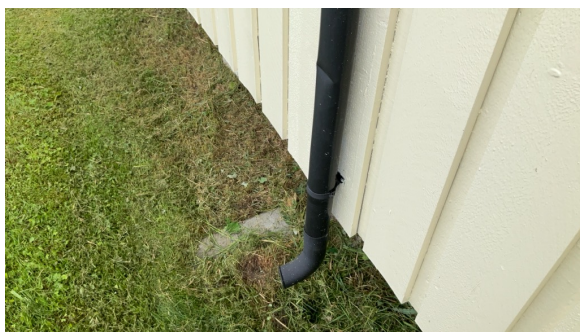
Takvannet ledes ikke vekk fra bygningen.
