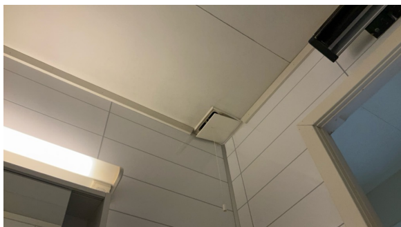
Kun naturlig avtrekksventil i himling.
