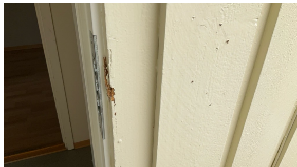
Sakke på kledning.
