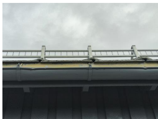
Takrenner og utvendige nedløp - Skade på takrenne og slitasje på beslag
