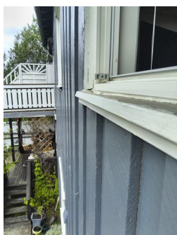
Vinduer og omramming - Slitt vannbord med motfall
