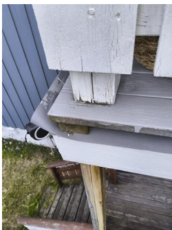
Tilstand på rekkverk og overflatematerialer - Slitt overflatebehandling
