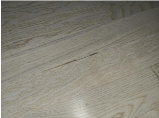
Overflate gulv - Skade i gulv på soverom
