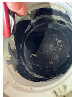
Bilde av sluk og membran er oversendt av eier.
