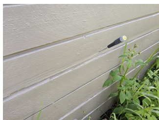
Veggkonstruksjon og fasadematerialer - Råteskader trekledning garasje.
