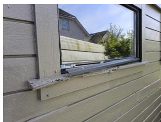
Vinduer, dører og porter - Funksjonssvikt vinduer carport.
