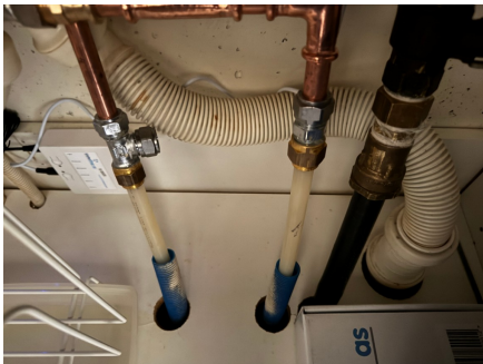
Vannrør av plast i benkeskap på kjøkken
