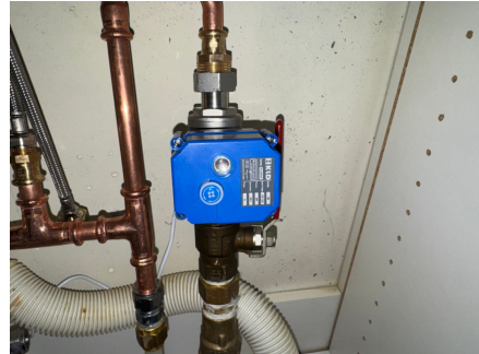
Stoppekran i benkeskap på kjøkken
