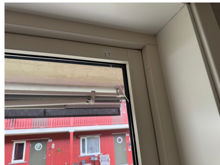
Sprekk i glass på terrassedør
