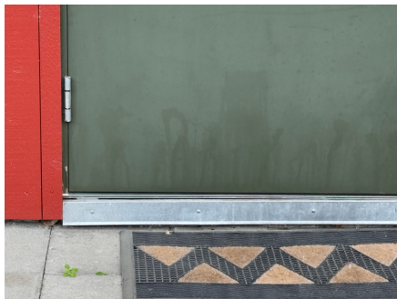
Beslag under dør som har falt ned noe på en side
