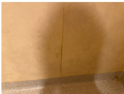
Sprekk i tapet på vegger i våtsone
