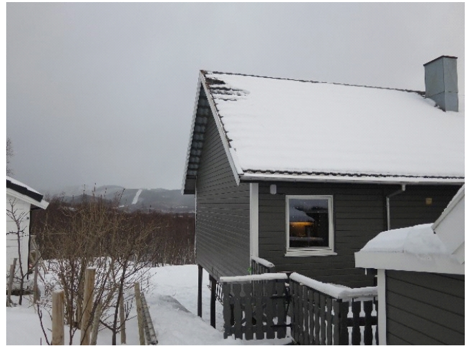
Skade langs takutstikk mot nordvest.
