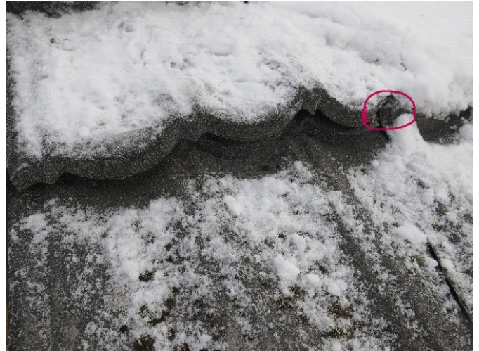
Kun 1 spiker i denne plata. Ingen spiker til venstre for markeringen på bildet. Monteringsveiledningen sier 4 spiker eller skruer i hver plate.
