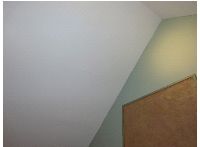
Bul langs plateskjøt skyldes dårlig malerarbeid, ikke lekkasjer.
