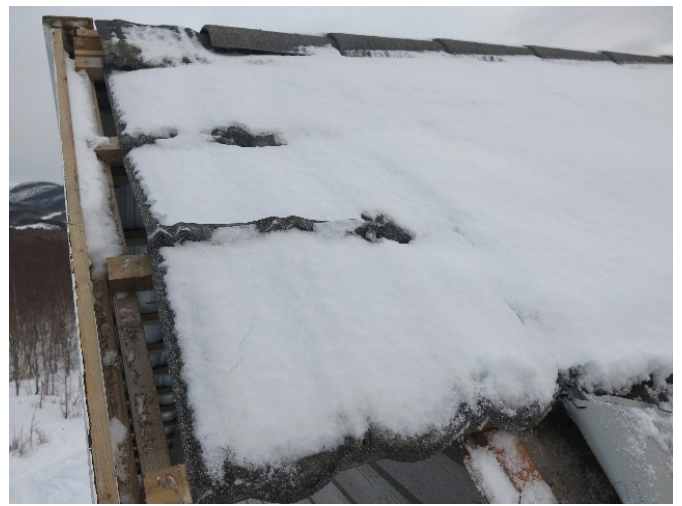
Tekkingen er løs langs gavl mot nordvest
