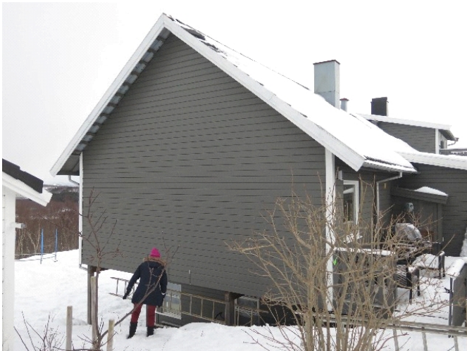
Skade langs takutstikk mot nordvest.
