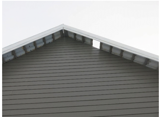
Takutstikket har ingen kledning på undersiden, og gjør det spesielt skadeutsatt.
