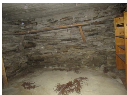
Slam på gulv i kjeller under opprinnelig del og fukt i grunnmur/gulv.
