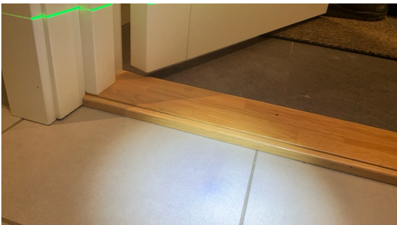
Det forutsettes at det er vanntett sjikt 15 mm over ferdig gulv bak eikelist.
