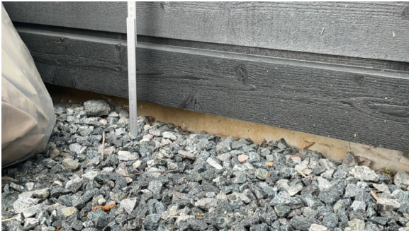
Lav høyde mellom grunnen og kledning.
