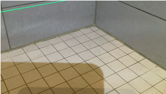
Sprekker i mykfuger i overgang gulv-vegg i dusjsone.
