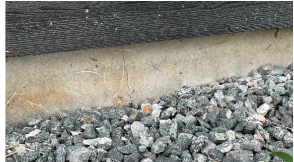
Det er observert riss i grunnmursplatene, noe som ofte forekommer på denne typen konstruksjoner.
