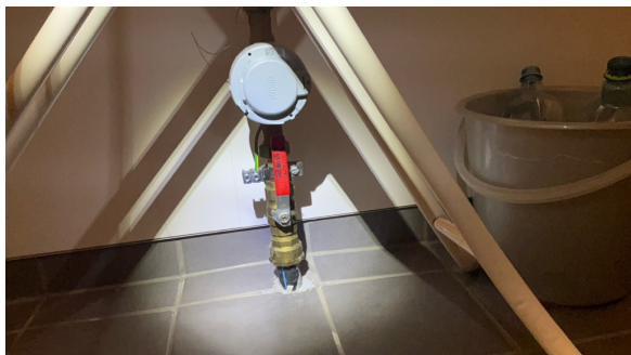
Vannmåler og stoppekran i vaskerom
