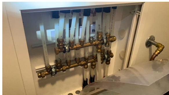
Fordelerskap i vaskerom.
