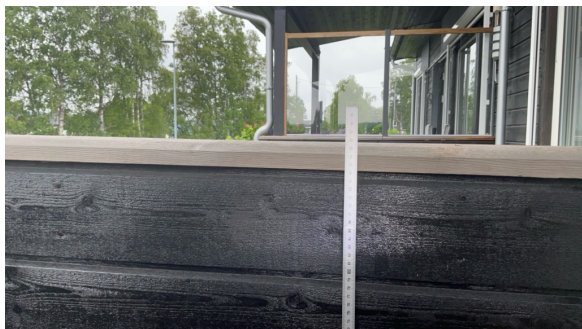
Rekkverk på veranda er ca. 4 cm for lavt.
