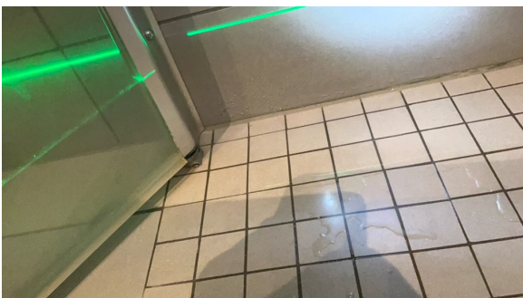
Lite fall på mindre del av gulvet i nedslagsfelt dusj.
