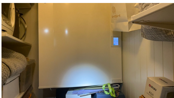
Ventilasjonsaggregat i bod.
