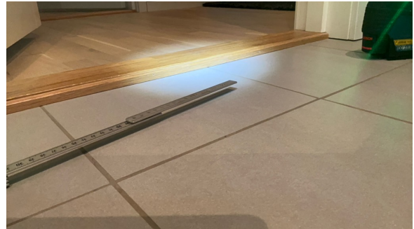
Det forutsettes at det er vanntett sjikt 15 mm over ferdig gulv bak eikelist.
