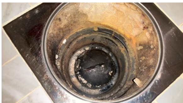
Plastsluk: Tettesjikt/membran er ikke tilstrekkelig klemt til sluket.
