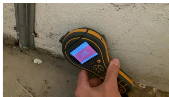
Fuktmåling indikerer fuktvandring og fuktopptrekk via kjellergulv.
