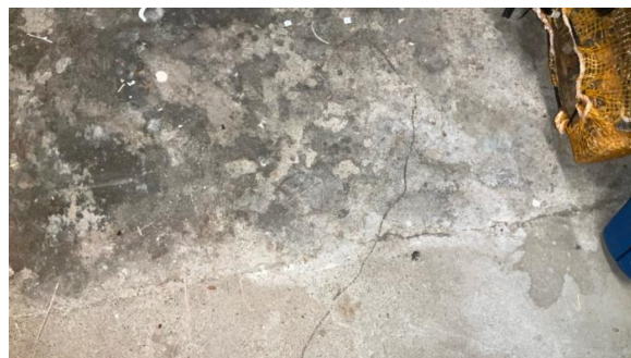
Minire sprekker i gulv er observert.
