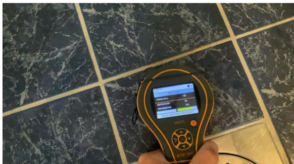
Gulv: Ved enkle fuktsøk og bruk av fuktindikator registrerte jeg verdier utover hva som forventes som normalt på utsatte steder.
