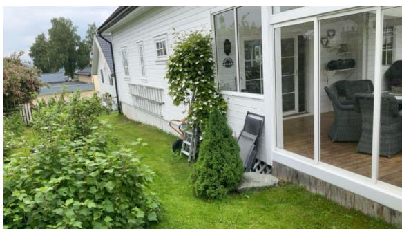
Stedvis fall på terreng mot bygning.
