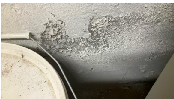
Saltutslag og malingsflass på vegger er registrert.
