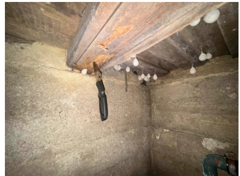
Råte i bjelkelag
