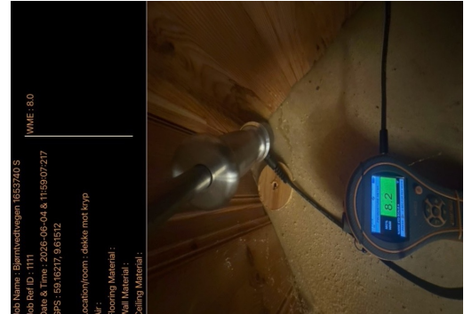
Fuktmåling uten fuktighet under trapp mot kryprom uten tilkomst
