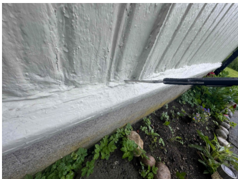
Stedvis råteskader i kledning
