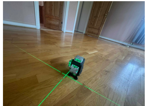
Skjevheter målt i rom i begge etasjer
