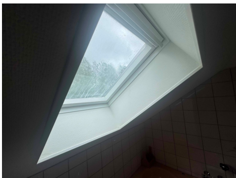
Takvindu med punktert glass
