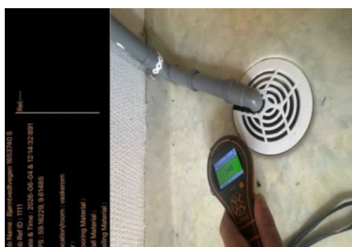
Fuktøk uten fuktighet
