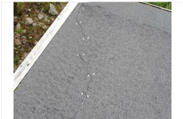
Skade/rift i asfaltapp
