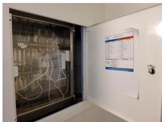
Fordelerskap og fordelerstammer - Fordelerskap plassert på toalettrom.
