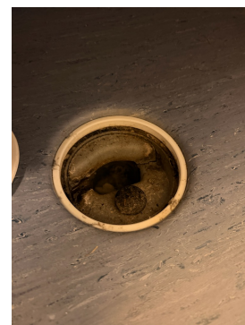
Sluk under servanttinnredningen.
