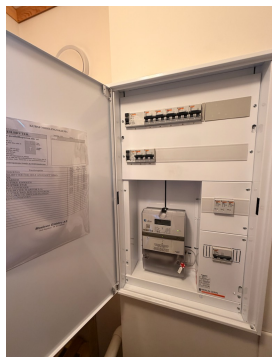
Sikringskap med automatsikringer.
