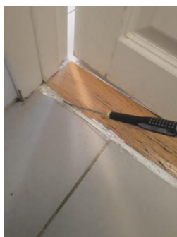
Lekkasjesikkerhet - Lekkasjesikkerhet ved dørterskel
