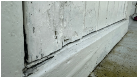
Råteskader balkongdør loft.
