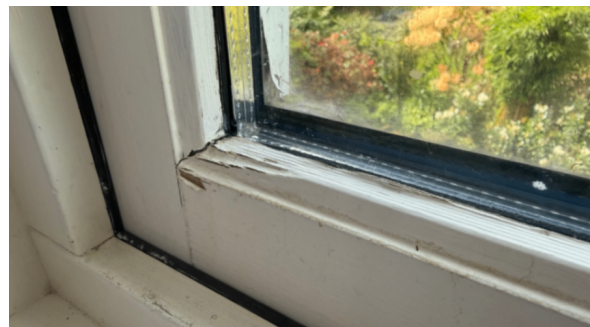
Fuktskader på innvendig karm.
