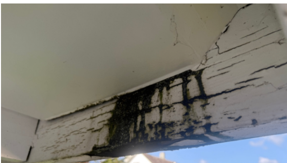
Fuktskader på bjelkelag pga ufagmessig utførelse av tetningsplater.
