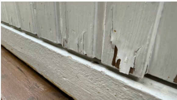
Slitasje balkongdør vaskerom.
