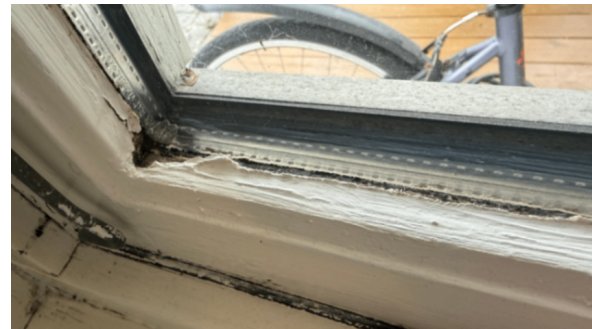
Fuktskaded vinduskarm som følge av innvendig kondensering.
