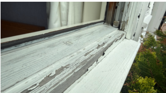
Flere av vinduene bærer preg av manglende vedlikehold.
