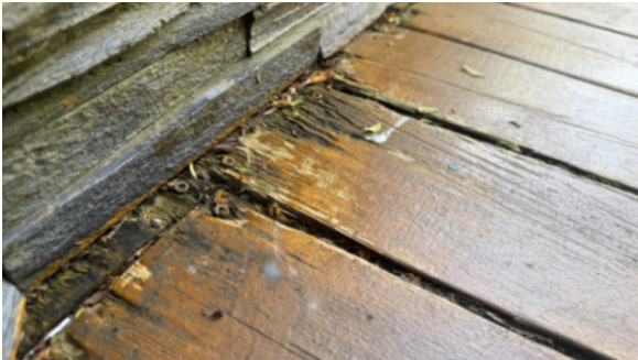
Råteskader i terrassebord mot mur.
