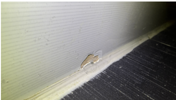
Skade på flis.
