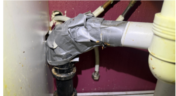
Ufagmessig utførelse av avløp.
