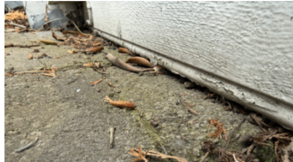
Kledningen ligger stedvis for nærme bakken.
