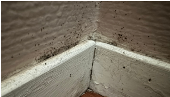
Svertesopp ved gulvlist soverom.
