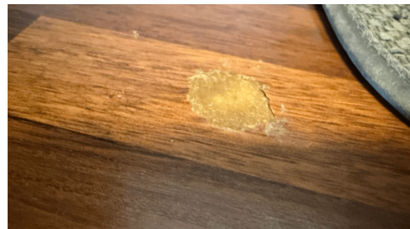
Skade på benkeplate.
