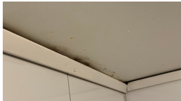
Svertesopp i taket over dusjsone.
