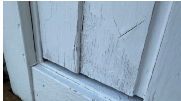
Slitasje balkongdør stue.
