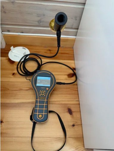
Fuktsøk fra tilstøtende rom.
