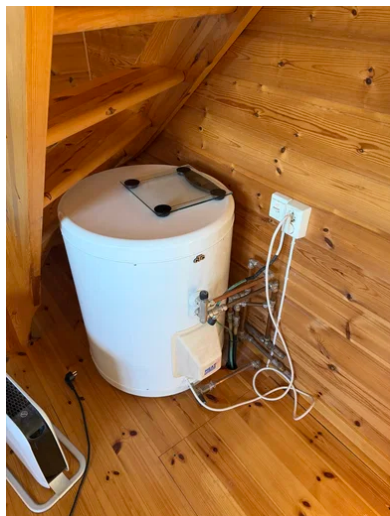
Vanninnstallasjon ved varmtvannsbereder.
