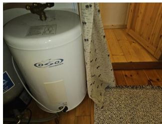
Varmtvannsbereder - Plassert på bad.
