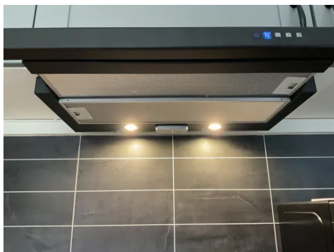
Mekanisk avtrekk over koketopp, komfyrvakt er montert
