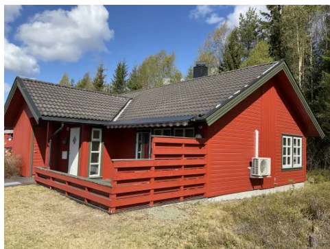
Utvendige fasader med preg av vedlikehold
