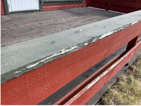
Malingavflassing og slitte overflater
