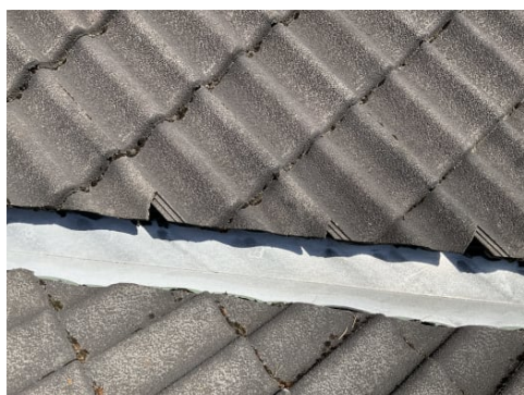
Flere steiner med brekkasjeskader
