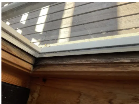
Innvendig ramtre med tegn etter mangelfull ventilasjon
