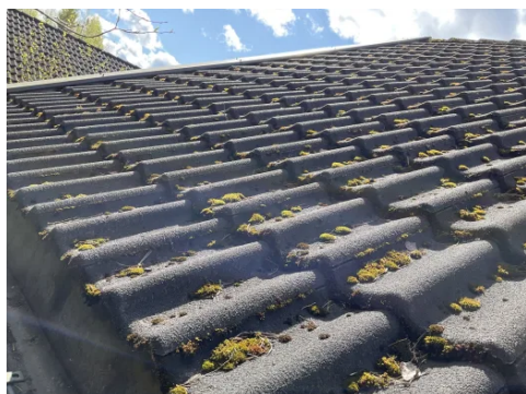
Takflater med mosedannelse
