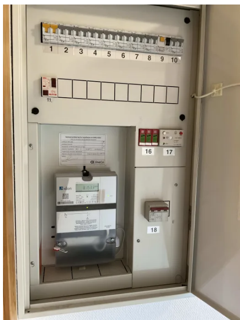
Sikringskapp plassert i vindfang
